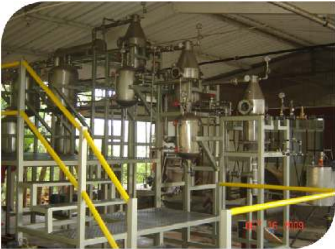
Figura 6. Prototipo del evaporador de múltiple efecto instalado en el CIMPA.
